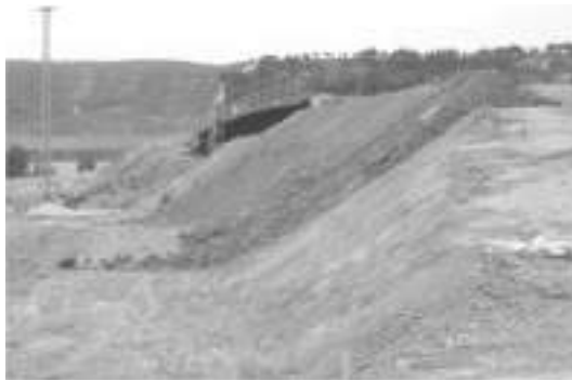
Figura 4. Reextensión de tierra vegetal en el talud de un paso superior sobre la carretera autonómica BU-600 (Burgos)
